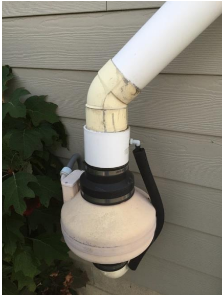
Photo: Radon Exhaust Fan
